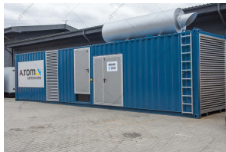
№10361 Дизельний генератор REHLKO (Kohler) T-1650 1320/1200 кВт закритого типу
